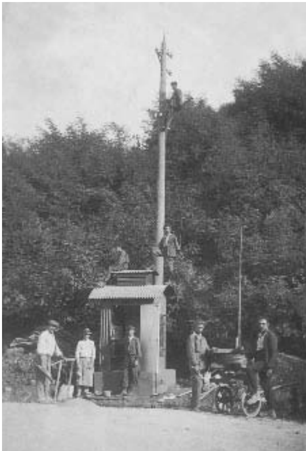
Die Etschwerke errichten in Tisens eine Transformatorstation sowie einen Strommasten (vor dem Ersten Weltkrieg).
